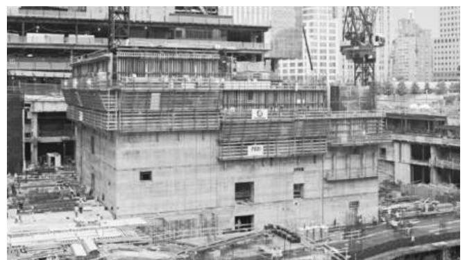
c. Hệ ván khuôn leo thi công theo phương thẳng đứng Hình 2-1: Phân loại hệ ván khuôn leo theo phương thi công.
