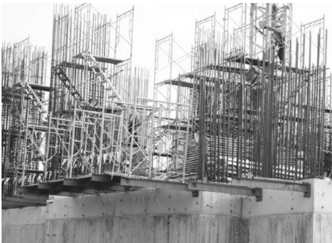
Hình 1-2: Một số cấu tạo liên kết hệ dầm I để đỡ hệ giáo ngoài
