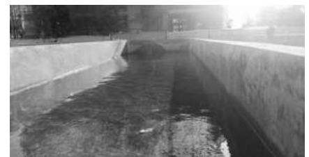
Hình 3.10. Bể hồi và cấp nước làm mát
